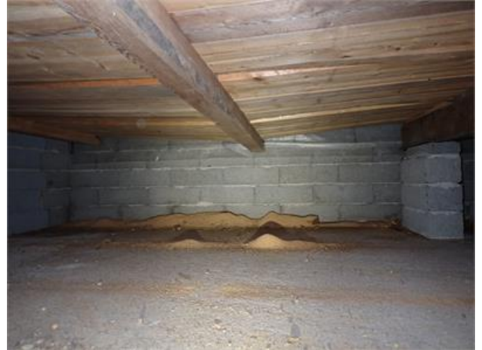
Exempel på blindbotten som hänger och organiskt material på betongplattan.
