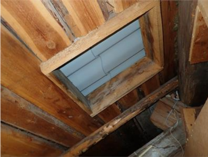
Bild på igenbyggd taklucka på vind.
